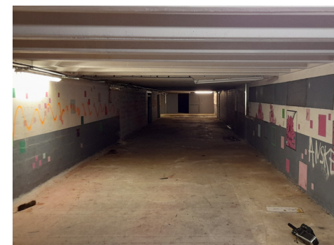
Premier sous-sol du parking, aujourd'hui condamné
